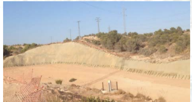
Aspecto de los taludes pendientes de ser restaurados
